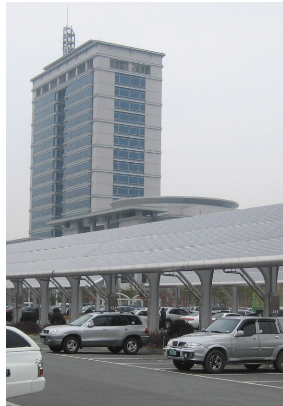
전북도청 130kW 태양광 발전설비
