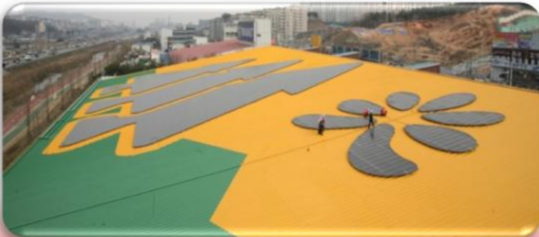
이마트 지붕형 태양광발전소 (서울마린시공)
